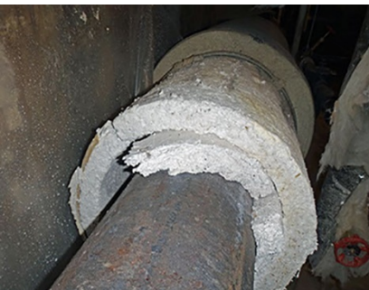
Asbestos Pipe Wrap
