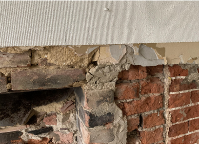
Asbestos Chimney Flue
